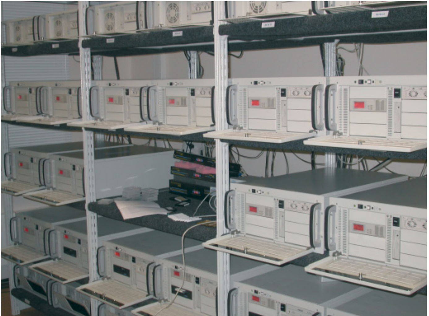
Сборка и тестирование аппаратуры системы видеонаблюдения проводились на стенде поставщика до отправки на объект
